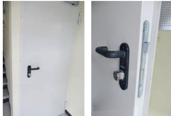
Schließanlagen in der Herschelstraße für eine Brandschutztüre
